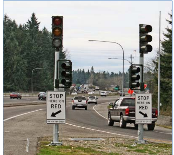
WSDOT Ramp Meter
